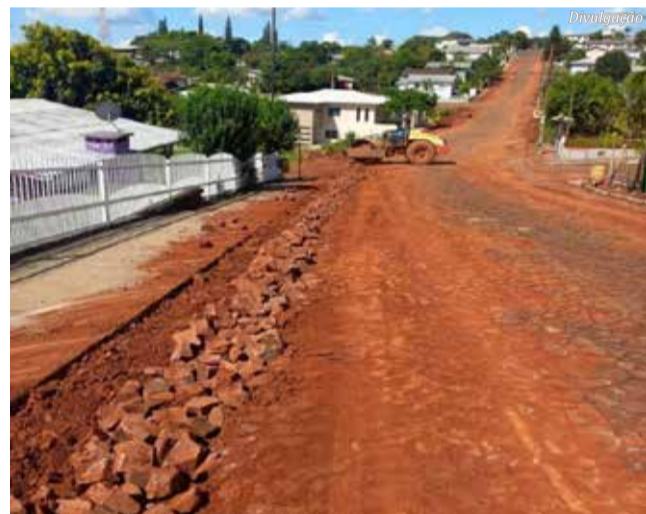
Esse é apenas o trecho final da adutora, que já tinha 4,5 km de adutora instalada
