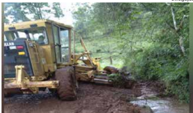
A situação obrigou a Secretaria de Transportes e Obras a acionar as equipes para reparar tais pontos
