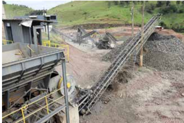
Britador Volta Grande em operação
