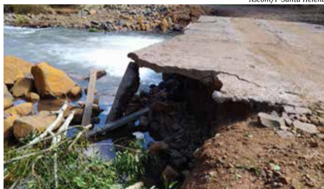
As fortes chuvas danificaram muitas estradas, pontes e cabeceiras de pontes
