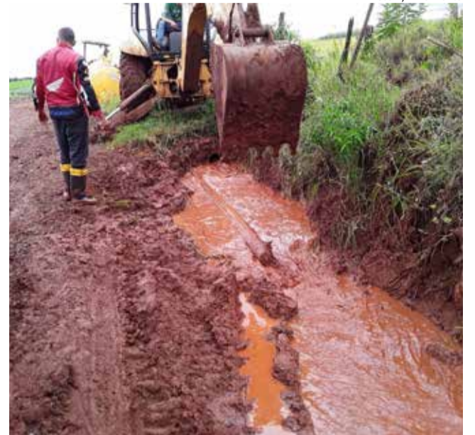
Chuva danificaram estradas e bueiros recentemente recuperados pela equipe de Obras
