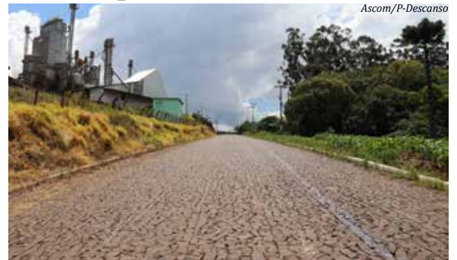
Uma das obras é o asfaltamento da rua Humberto de Campos até a SC 496, que dá acesso aos municípios de Belmonte, Santa Helena e Tunápolis
