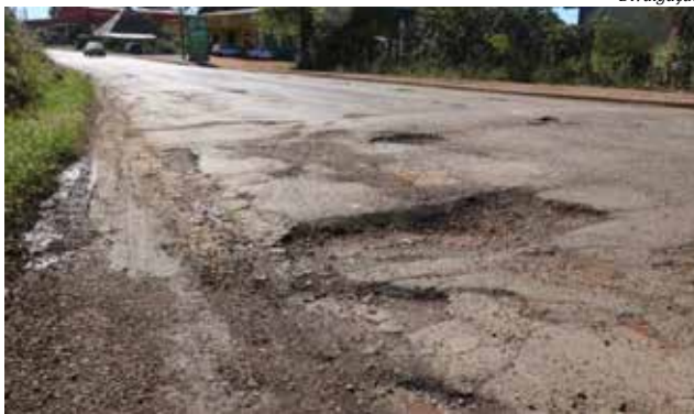
BR-163, hoje em estado precário, é uma das rodovias federais dentro do pacote de concessões
