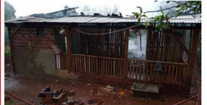
Quando os bombeiros chegaram, a residência já estava tomada pelas chamas
