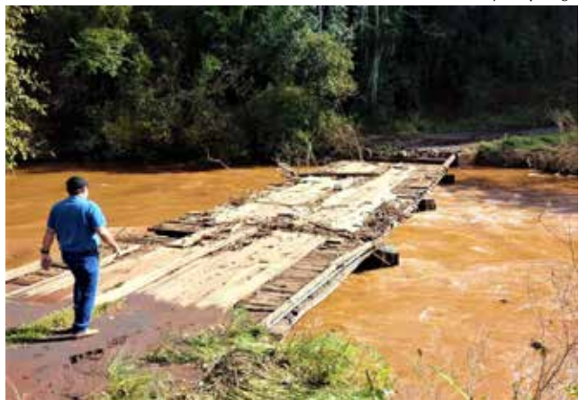
Parte da estrutura de madeira foi levada pela enxurrada registrada no mês de junho
