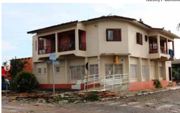
Em Belmonte, força dos ventos deixaram estragos em várias partes da cidade e interior
