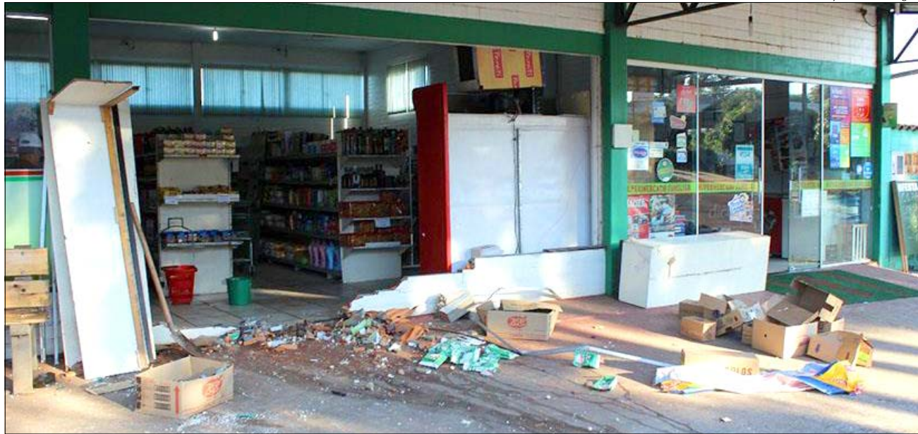
Prejuízos ao mercado foram de grande monta, com destruição da fachada e perda de mercadorias
