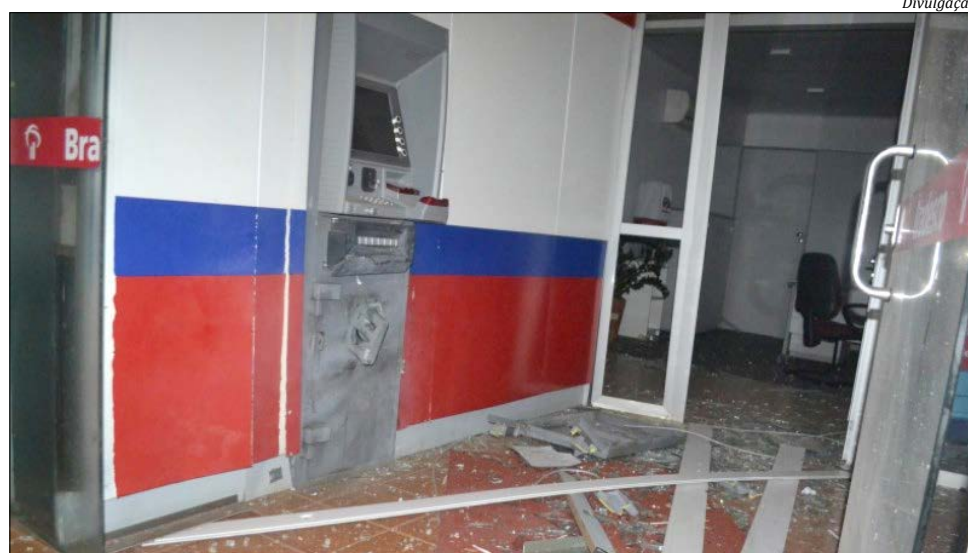
Agências ficou bastante danificada pela explosão
