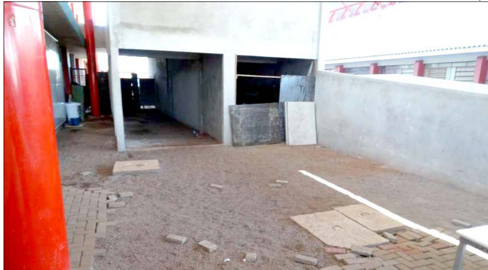
A estrutura está pela metade, com salas, laboratórios e pátio incompletos
