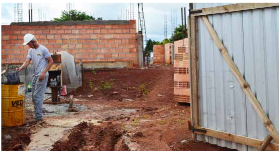
Construção da Escola Municipal, a cargo da empresa de Engenharia Cleonor Mahl, continua em ritmo acelerado
