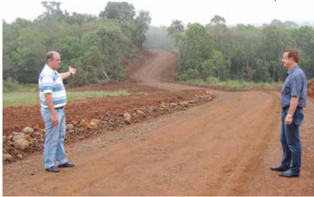
Prefeito Hélio Daltoé e o secretário de Transportes, Lenoir Povala, vistoriaram as obras no interior
