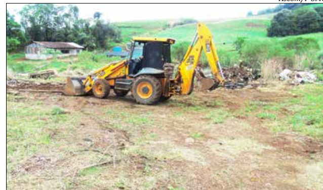
A equipe da Secretaria de Obras trabalha na infraestrutura do local onde acontece a feira
