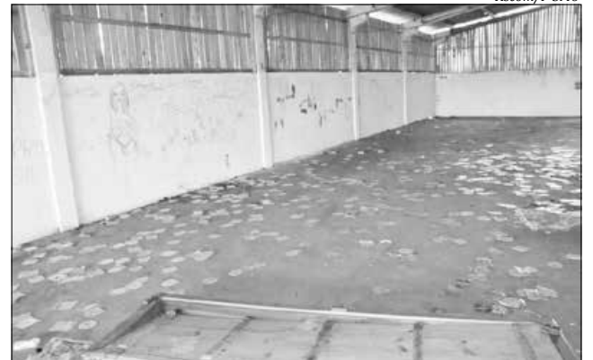
Paredes pichadas, centenas de CDs espalhados pelo chão, vidros e garrafas quebradas foram encontrados na manhã da segunda-feira
