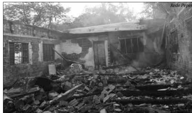
Apesar do esforço dos bombeiros, o fogo consumiu toda a residência
