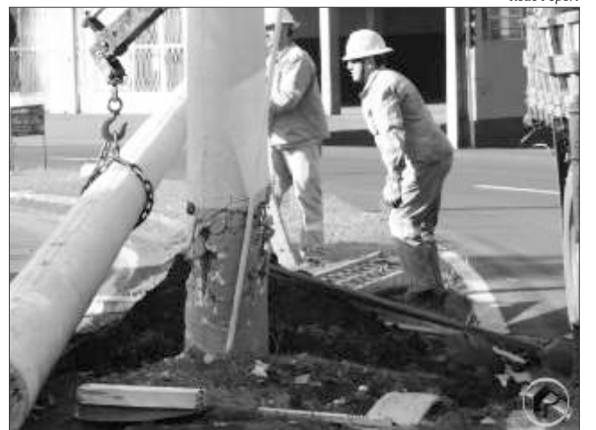
Com o choque, o poste teve a estrutura comprometida e foi removido
