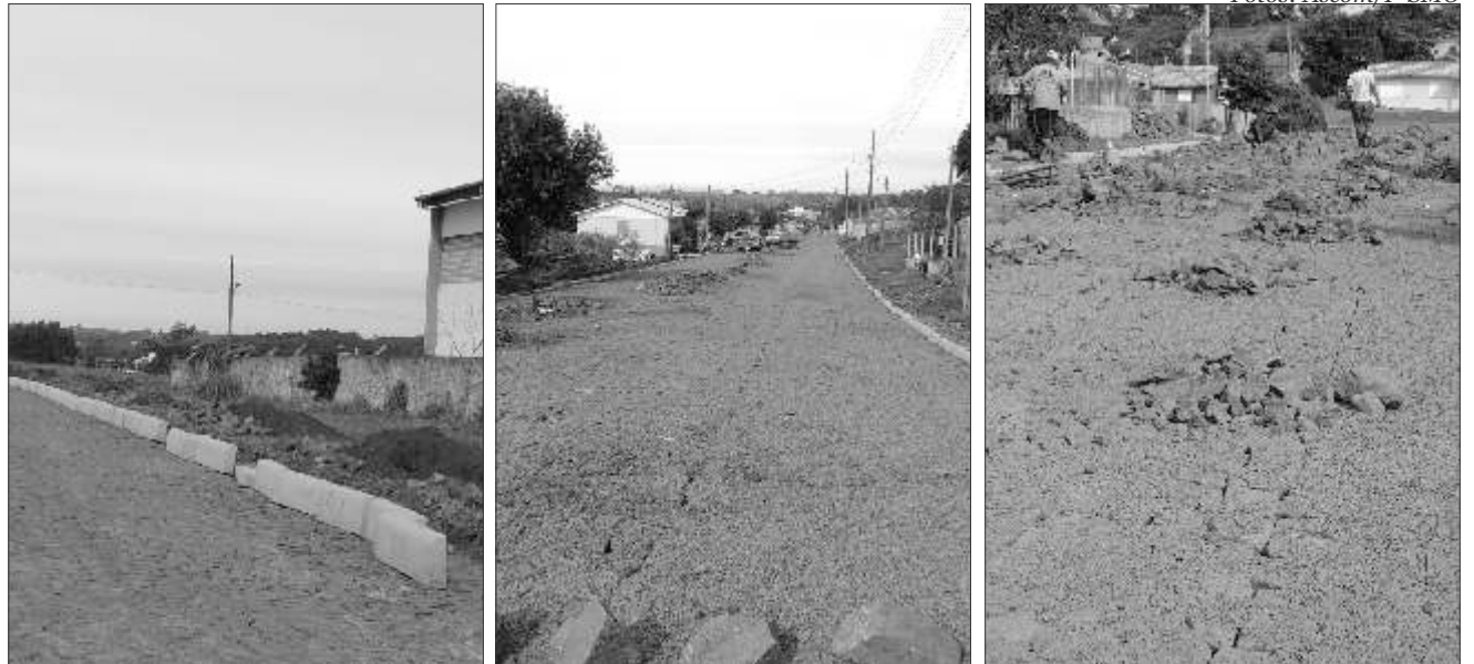
Obras estão sendo feitas em diversas ruas: Hélio dos Anjos (e), Piauí (c) e Joaquim Nabuco (d)
